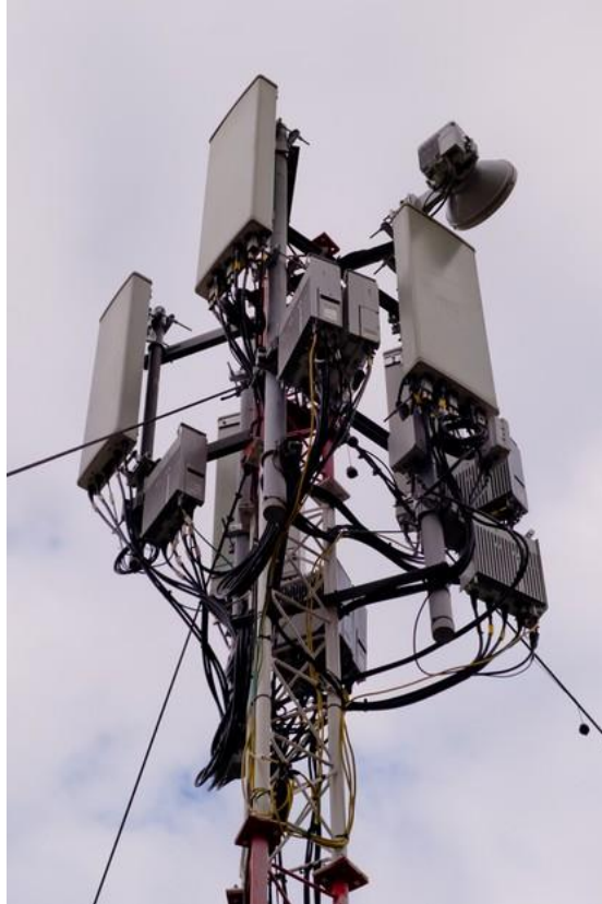
Figura 8 Antenas de transmisión fuente: (Redes y telecom, 2021)
