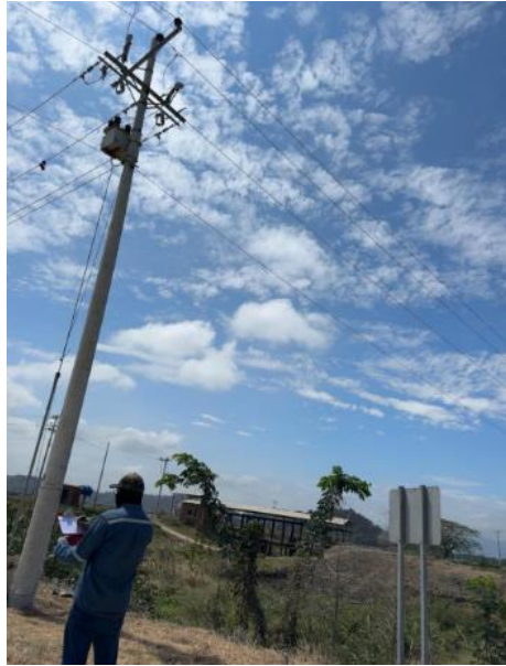
Figura 32. Inspecciones con planillas para media tensión. Fuente propia.
