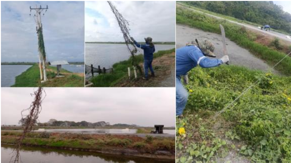
Figura 23. Retiro de maleza en los postes para evitar aterrizamiento de línea. Fuente propia.
