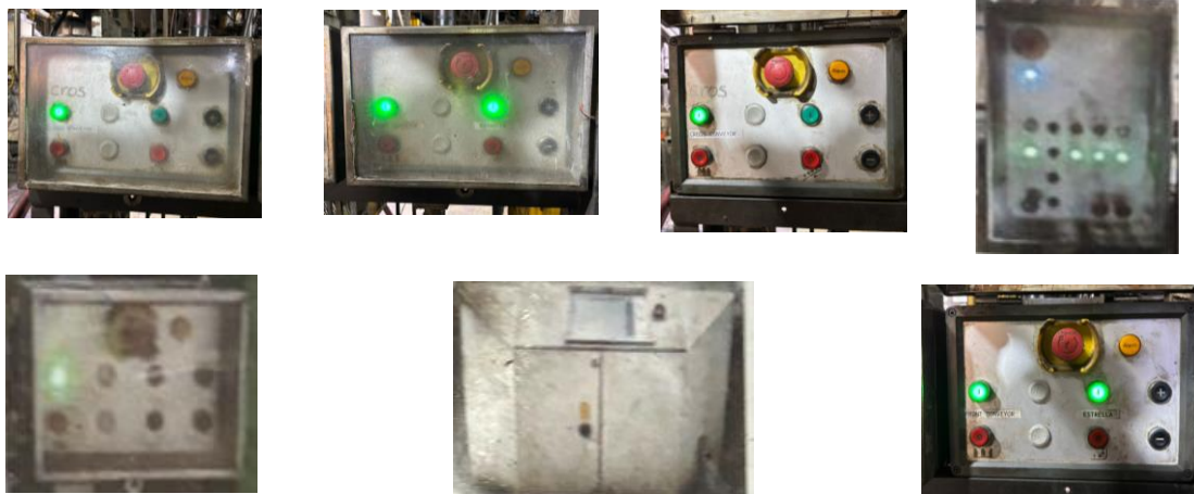
Figura 9: Puntos de bloqueo eléctrico de máquinas formadoras. Fuente: Propia de los autores.
