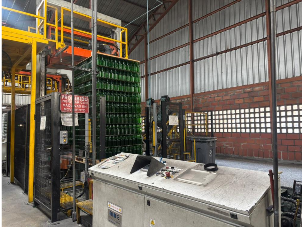
Figura 19: Fuentes de energía eléctrica y neumática de sunchadora. Fuente: Propia de los autores.
