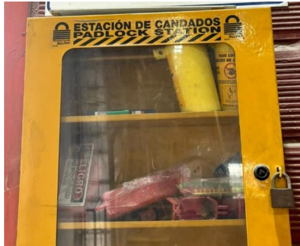
Figura 6: Gabinete de bloqueo y etiquetado de la empresa manufacturera de envases de vidrio. Fuente: Propia de los autores.
