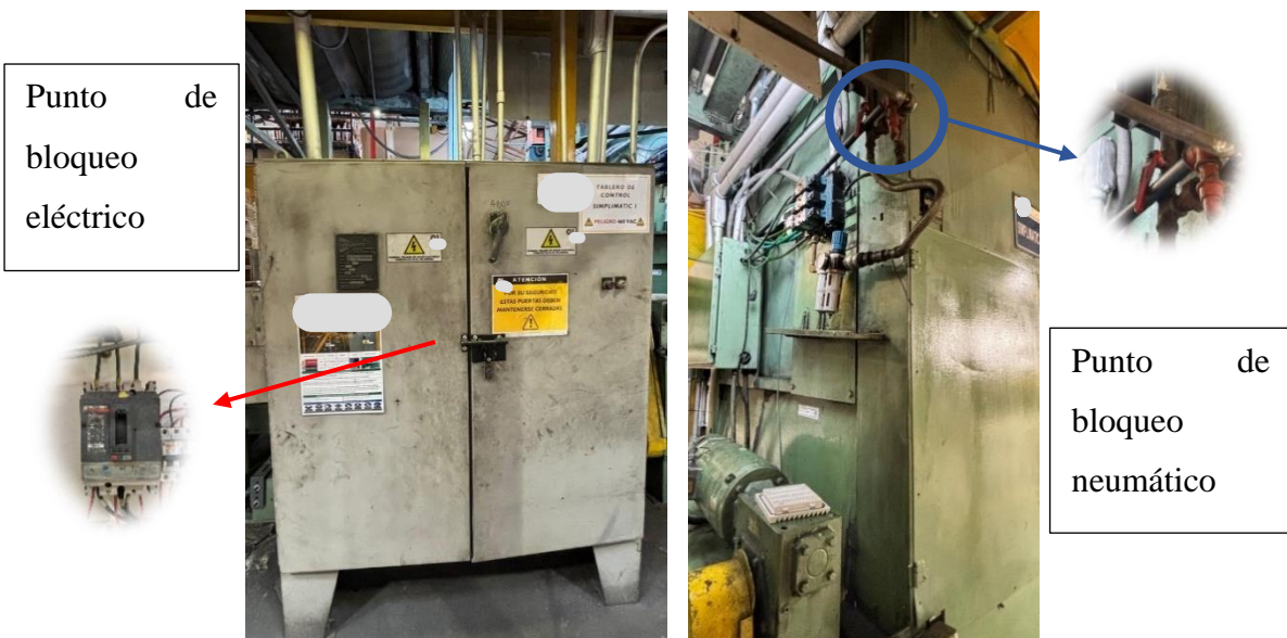
Figura 18: Punto de bloqueo eléctrico y neumático de paletizadora. Fuente: Propia de los autores.
