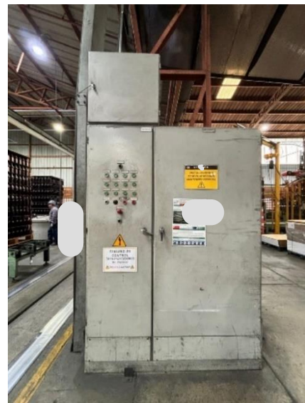
Figura 11: Fuente de energía eléctrica. Fuente: Propia de los autores.
