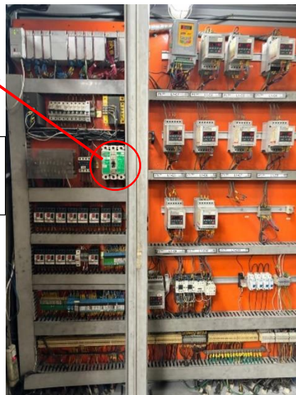
Figura 12: Punto de bloqueo eléctrico. Fuente: Propia de los autores.
